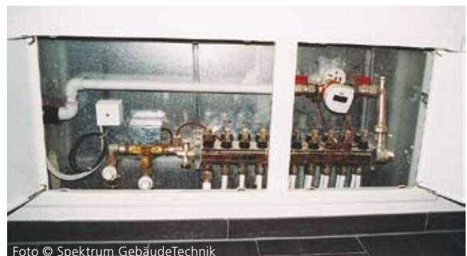
Foto © Spektrum GebäudeTechnik
